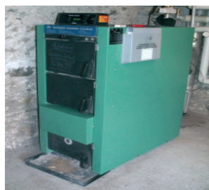
Chaudière à bûches
