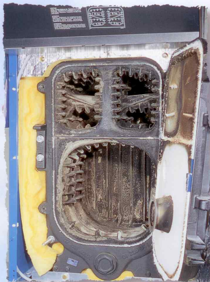
Chaudière après le ramonage mécanique.
