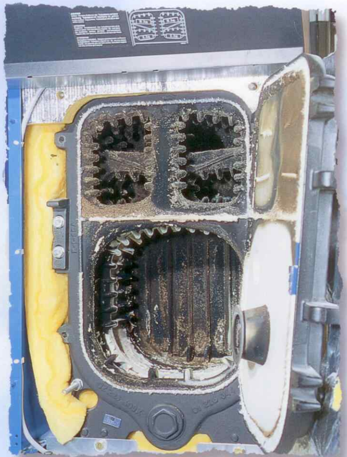
Chaudière encrassée, avant nettoyage.
